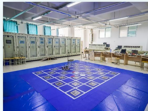
电力系统实训室
